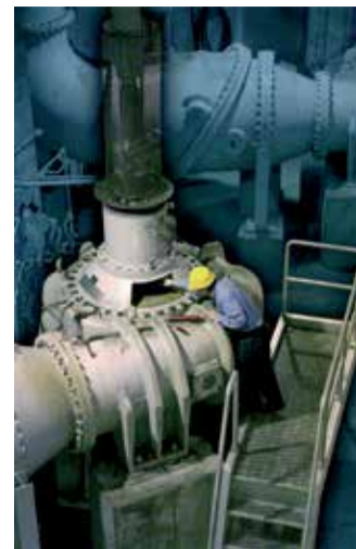
Die Demontage großer vertikaler Wasserpumpen verursacht oft hohe Dichtungsreparaturkosten
